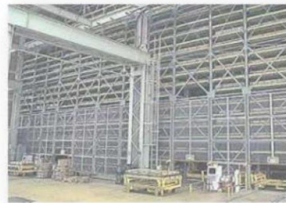
自動ラック倉庫
